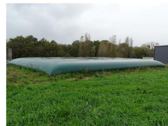
Réserve incendie au sud-ouest de la ZIP
