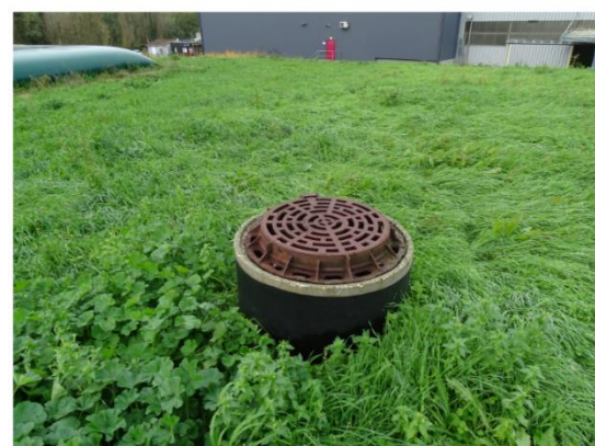
Event de biogaz au sud-ouest de la ZIP
